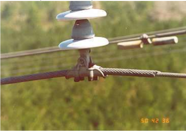
Figura 8 - Erro de instalação da armadura pré-formada (descentralizada).
