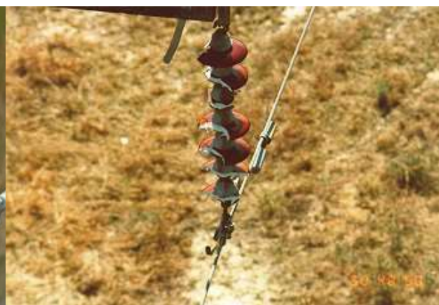
Figura 7 - Cadeia com várias unidades quebradas (provável vandalismo)
