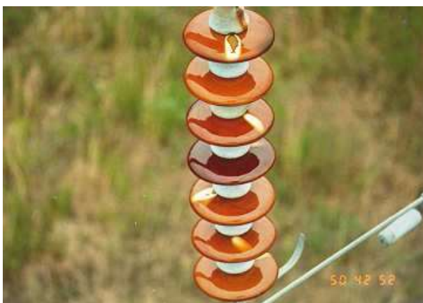
Figura 6 - Isolador de porcelana com sinais de descarga
