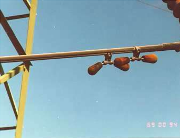
Figura 10 - Amortecedor Stockbridge com fadiga nos cabos mensageiros
