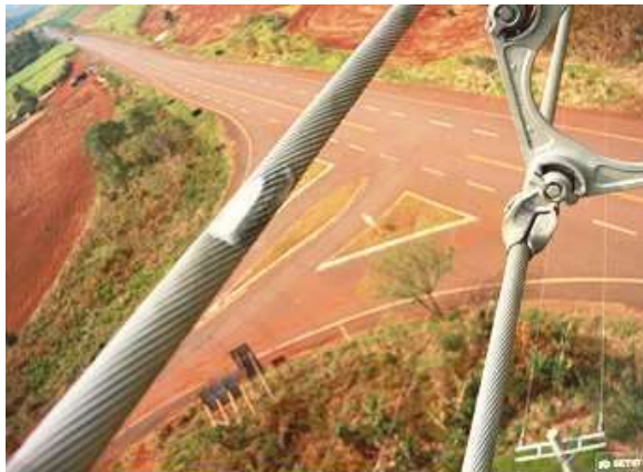
Figura 12 - Espaçador deslocado com danos ao condutor.
