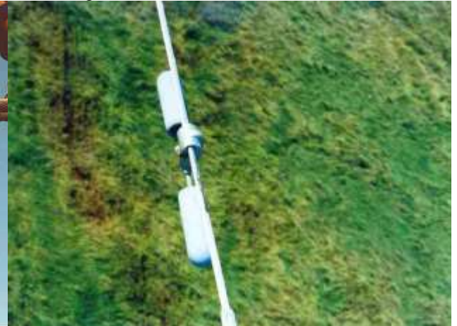
Figura 11 - Amortecedor deslocado e cabo pára-raios com tento partido em LT 750kV
