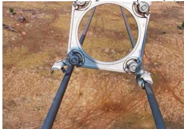
Figura 13 - Garra aberta devido à quebra do parafuso com defeito de fabricação (liga fora de especificação).
